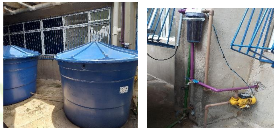
Imagem 2: Cisternas e sistema de bombeamento e filtragem
